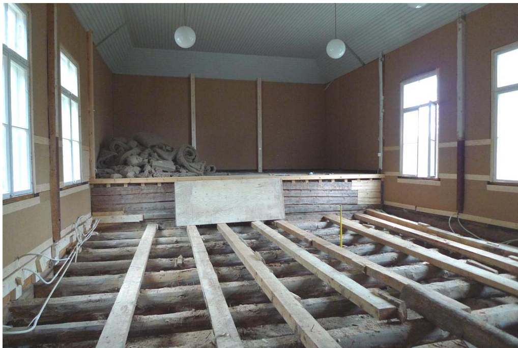
17.5.2012. Fyra dagar senare har golvfyllningen sugits med maskin ut och ligger på backen (bilden nedan). Vid närmare inspektion av golvbjälklagets konstruktioner visade det sig att hela konstruktionen var i så dåligt skick att allt måste rivas bort.
