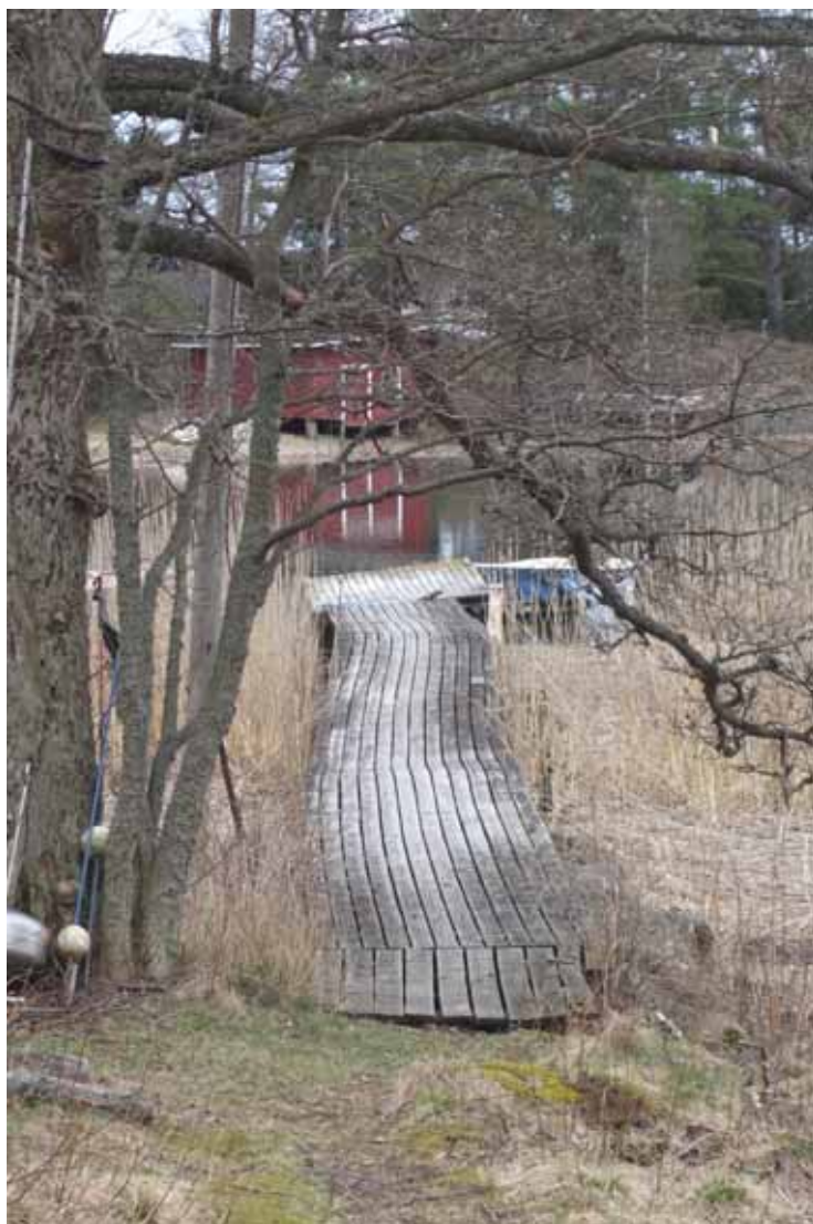
Snart måste nog bryggan repareras!
